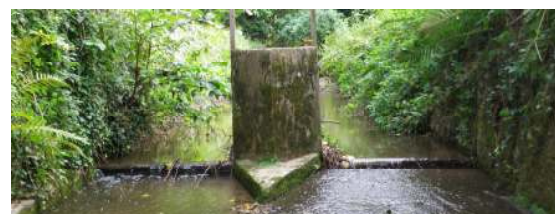
Glissières permettant d'augmenter la ligne d'eau du pour l'alimentation de l'étang
