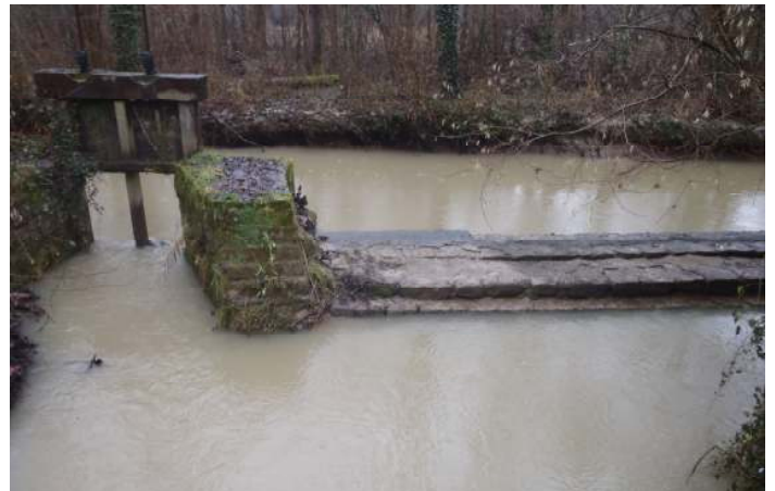
Vue de l'ouvrage du bras de décharge du moulin de Gandelu en temps de crues
