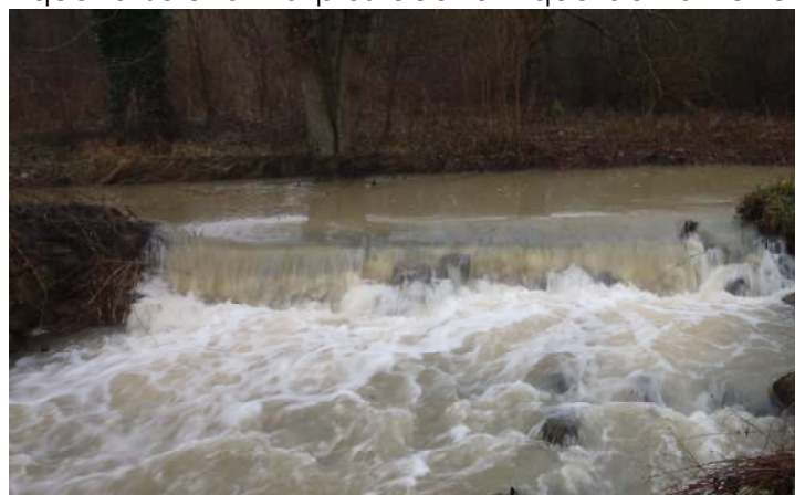
Vue de l'ouvrage du bras de décharge du moulin de Brumetz en temps de crues
