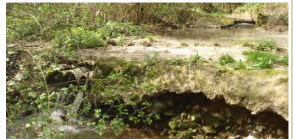
Ouvrages d'alimentation d'un étang
